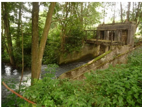
Vue depuis l'est du vannage totalement infranchissable par les espèces piscicoles
